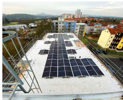
Im Leimenkauer Weg 3 wurde bereits eine Anlage installiert.
